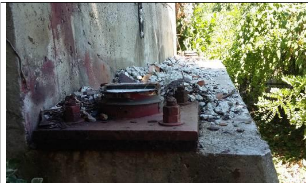
Foto 13: Particolare Appoggi mobili Spalla Sud
