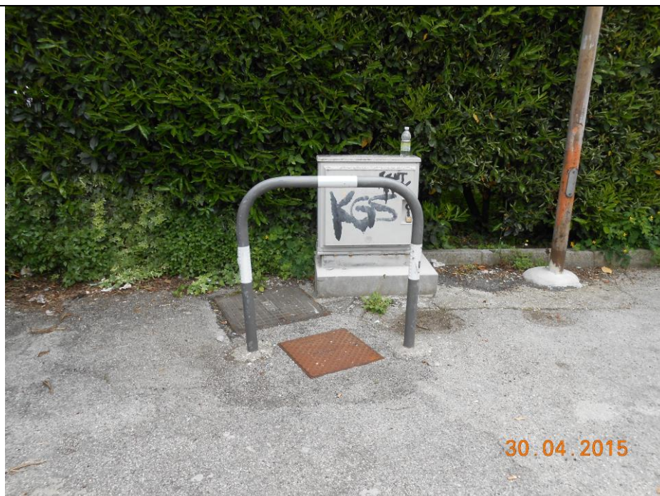
Foto 6: Cassetta collegamento illuminazione pubblica (particolare)
